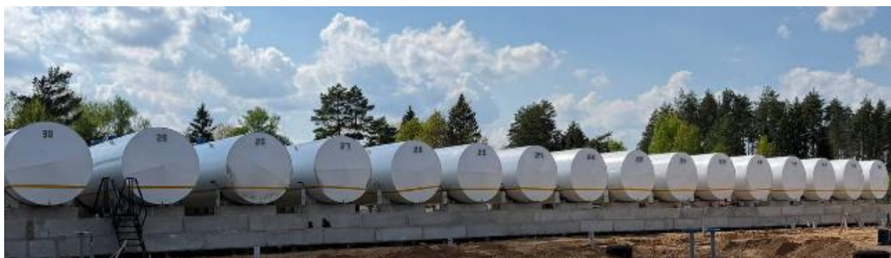
Рисунок 2 – Общий вид резервуаров РГСн-50
