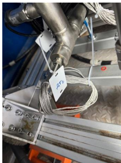
Рисунок 14 – Термометр сопротивления ТС716 в месте установки.
