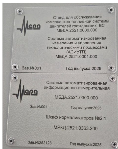
Рисунок 12 – Заводская маркировка шкафа нормализаторов №2.1
