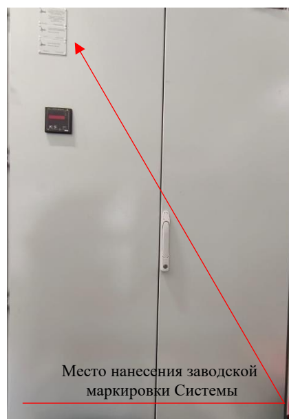
Рисунок 6 – Шкаф кроссовый АИИС. Вид внешний
