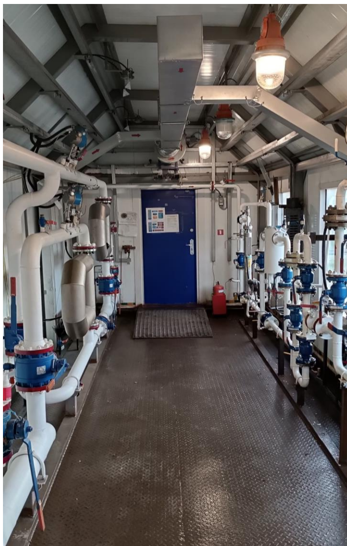
Рисунок 1 – Общий вид СИКН
