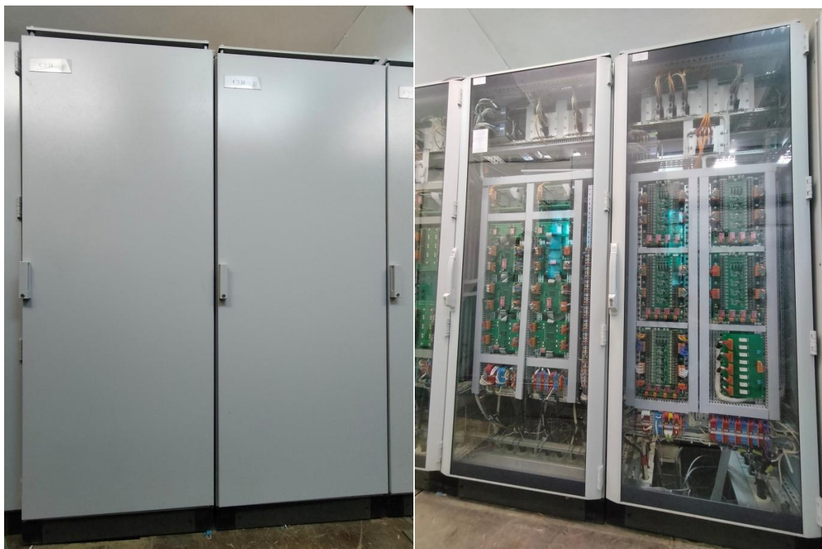
Рисунок 1 – Общий вид электротехнических шкафов СУ-СА3
