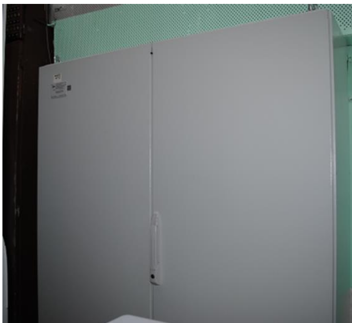
Рисунок 4 – Шкаф коммутационный. Общий вид
