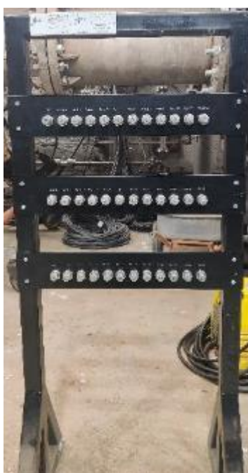
Рисунок 7 – Панель пневматической коммутации. Вид общий
