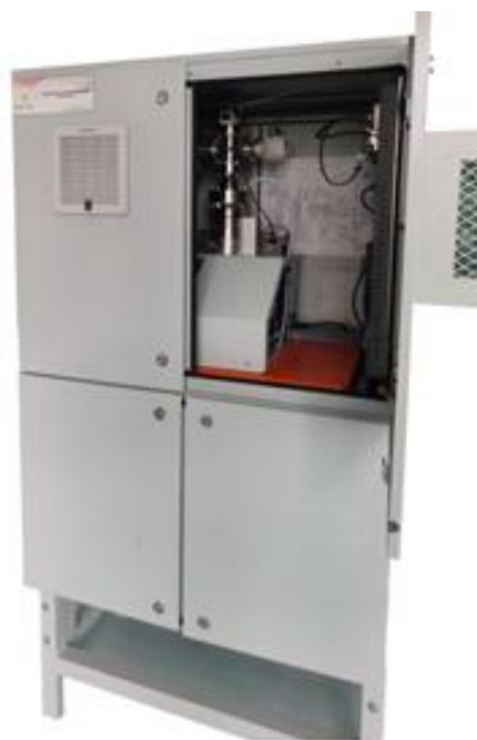
б) шкаф газоаналитический (квадрупольный масс-анализатор)
