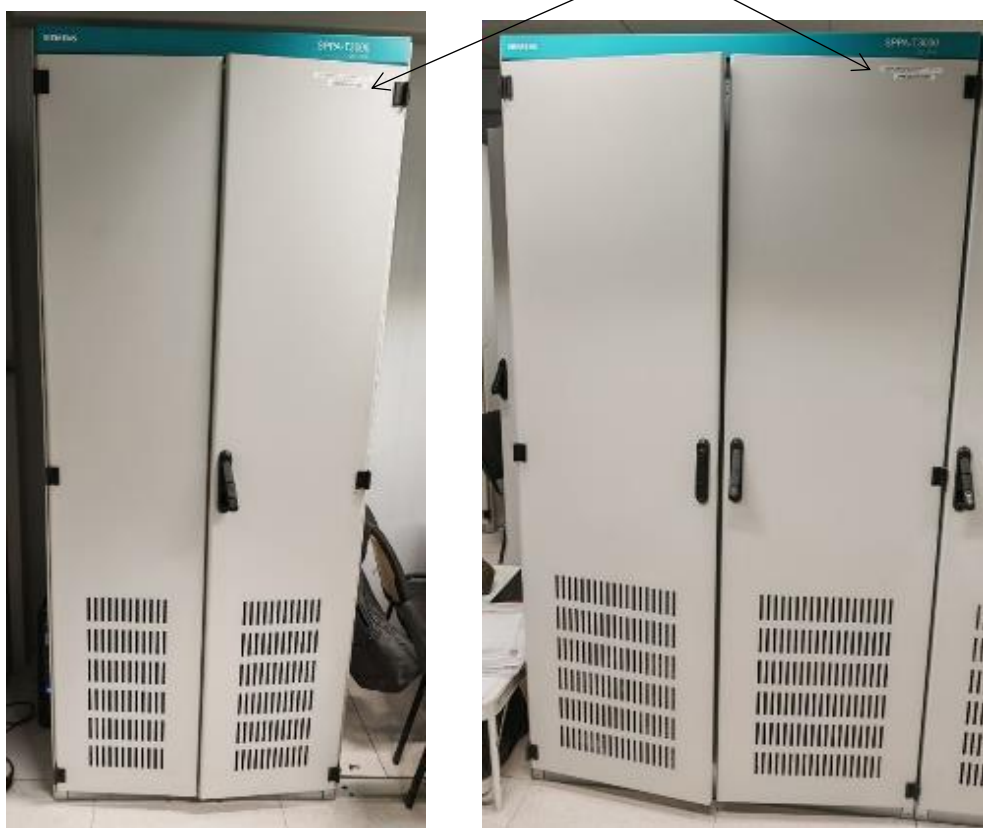
Рисунок 1 – Общий вид шкафов вторичной части системы
