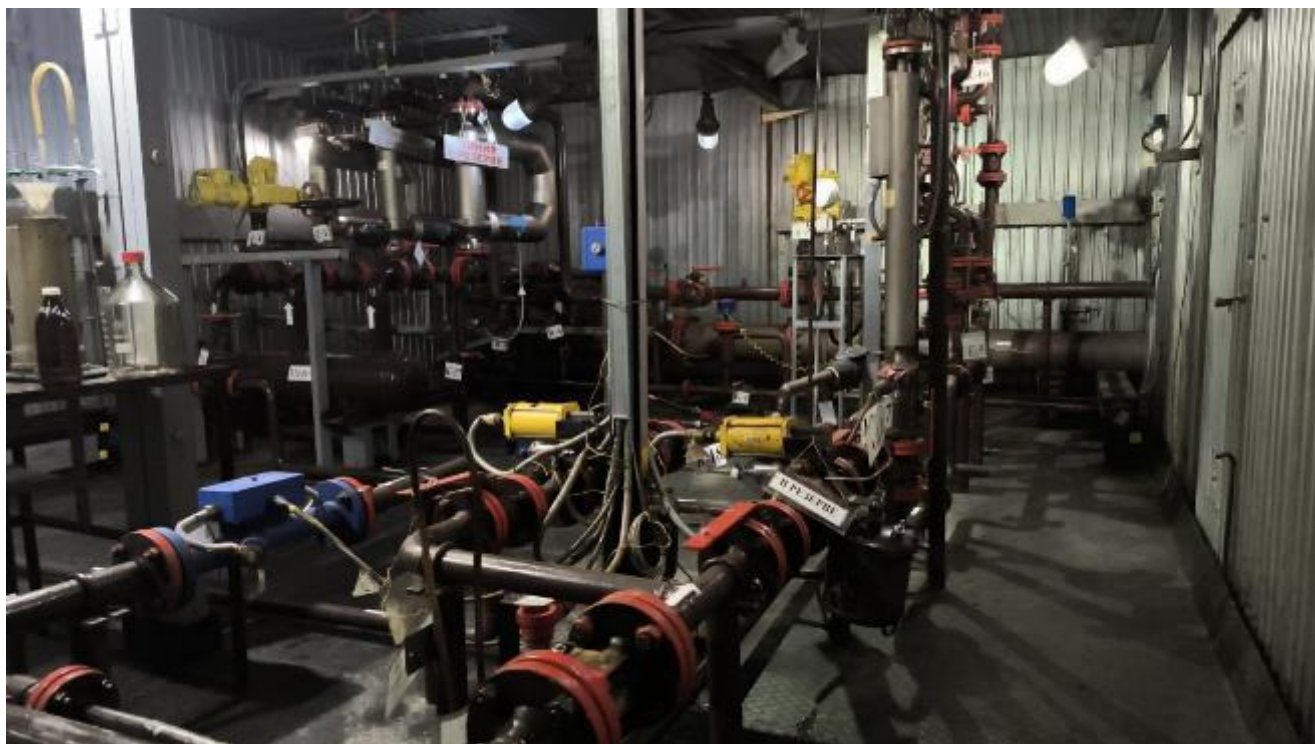
Рисунок 1 – Общий вид СИКН
