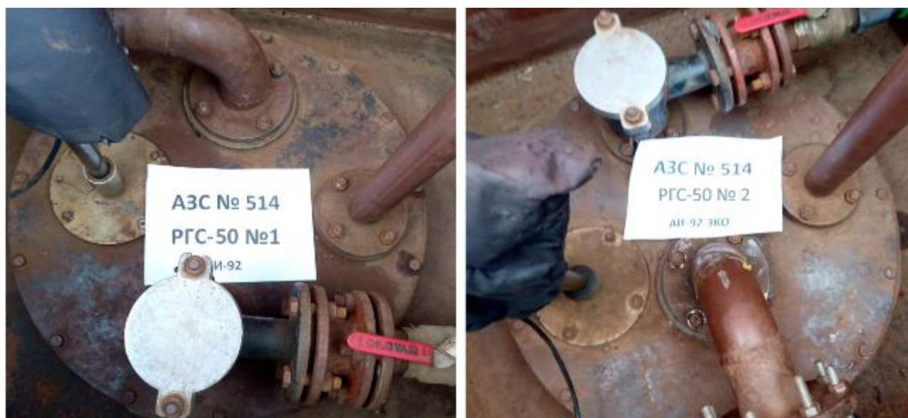
Рисунок 2 – Горловины резервуаров РГС-50 зав.№№ 1, 2
