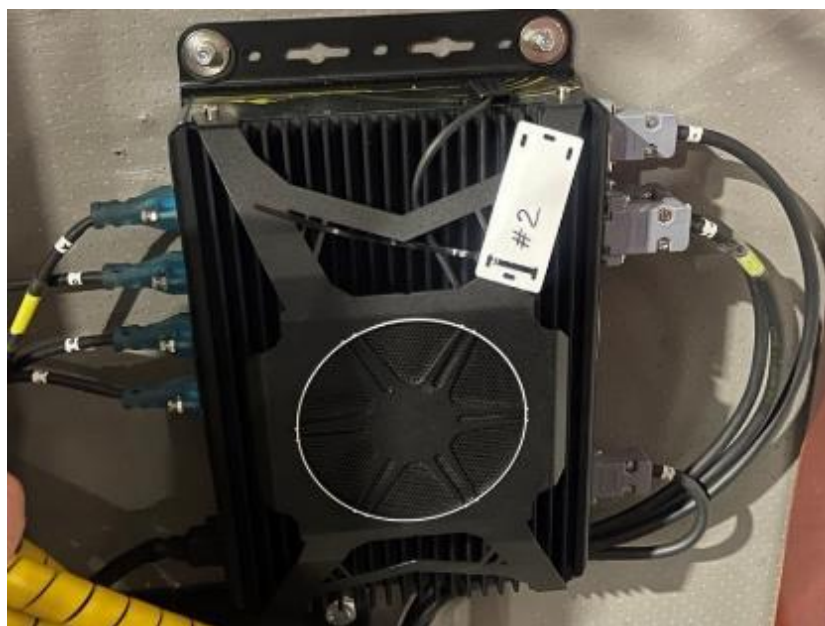
Рисунок 6 – Общий вид вычислительного модуля
