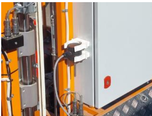
Рисунок 4 – Термопреобразователь сопротивления ДТС на боковой поверхно- сти электротехнического шкафа
