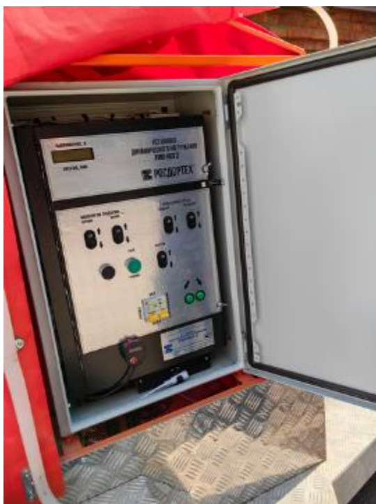
Рисунок 2 – Электротехнический шкаф с блоком управления
