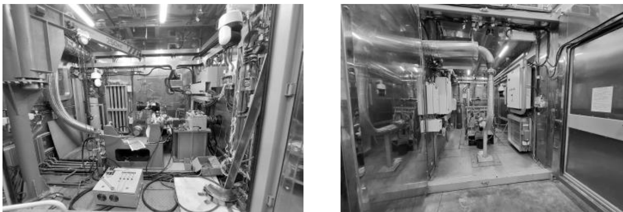
Рисунок 4 – Общий вид испытательных боксов системы
