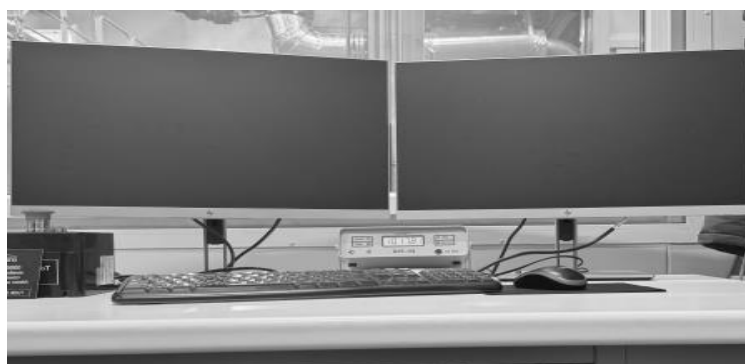
Рисунок 5 – Помещение пультовой, место оператора
