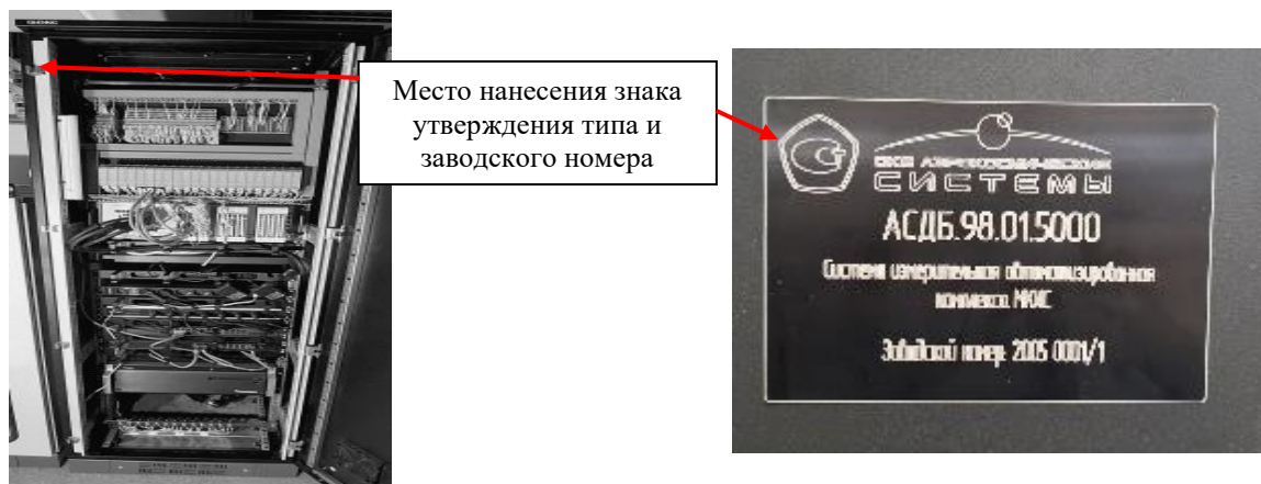
Рисунок 1 – Стойка управления системы. Общий вид
