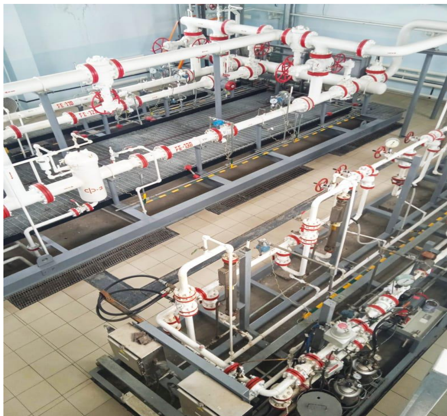
Рисунок 1 – Общий вид СИКН
