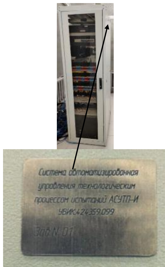
Рисунок 2 – Шкаф системы сбора данных (ССД)
