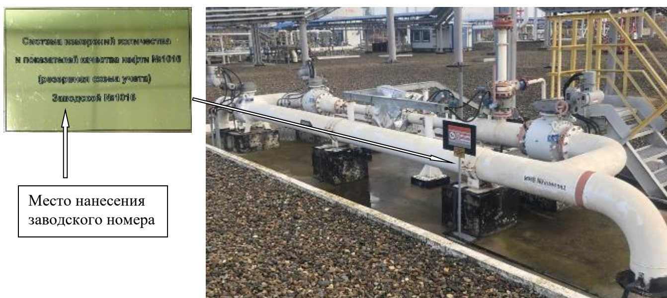
Рисунок 1 – Общий вид СИКН РСУ с указанием места нанесения заводского номера
