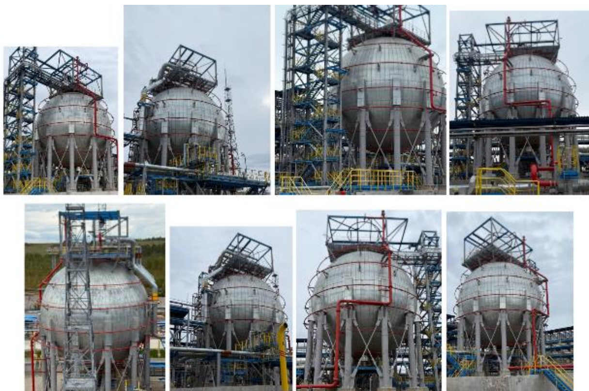
Рисунок 2 – Общий вид резервуаров РИС-2400
