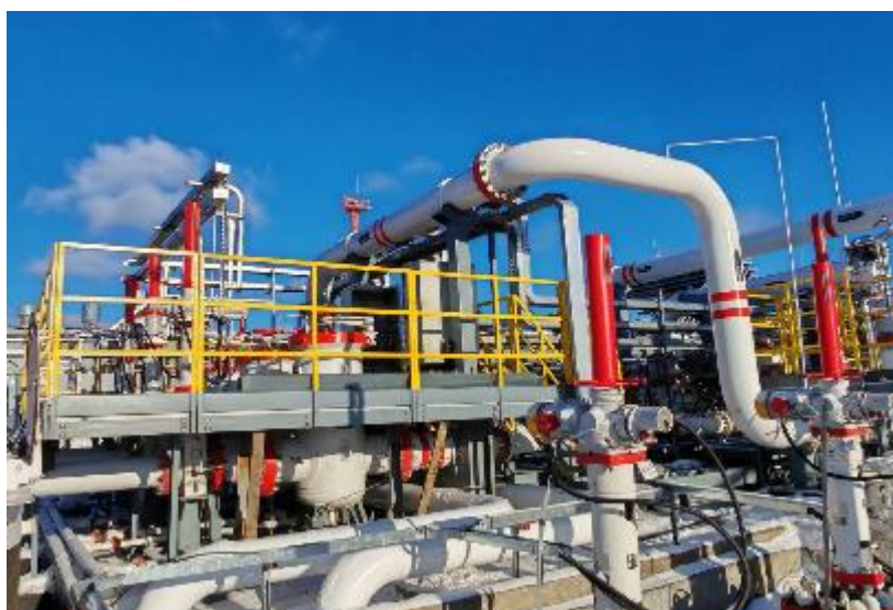
Рисунок 1 – Общий вид СИКН
