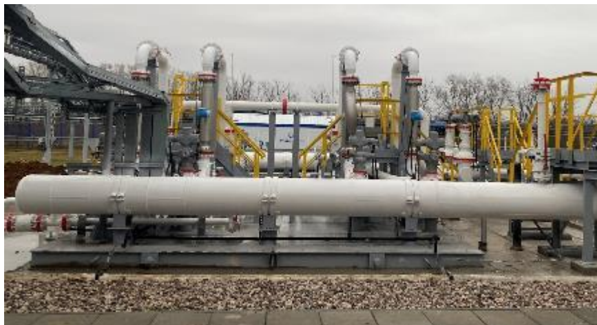
Рисунок 1 — Общий вид СИКН
