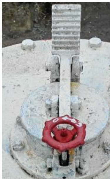
Рисунок 2 – Замерной люк резервуара
