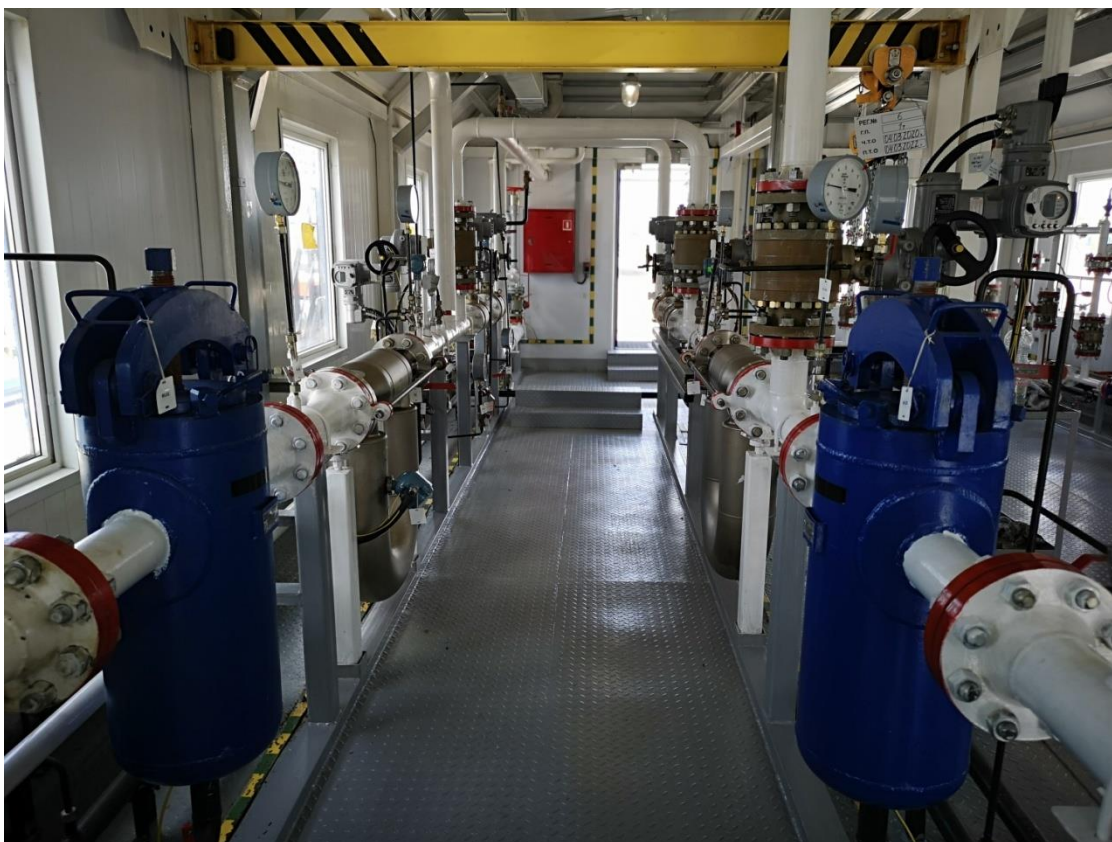
Рисунок 1 – Общий вид СИКН
