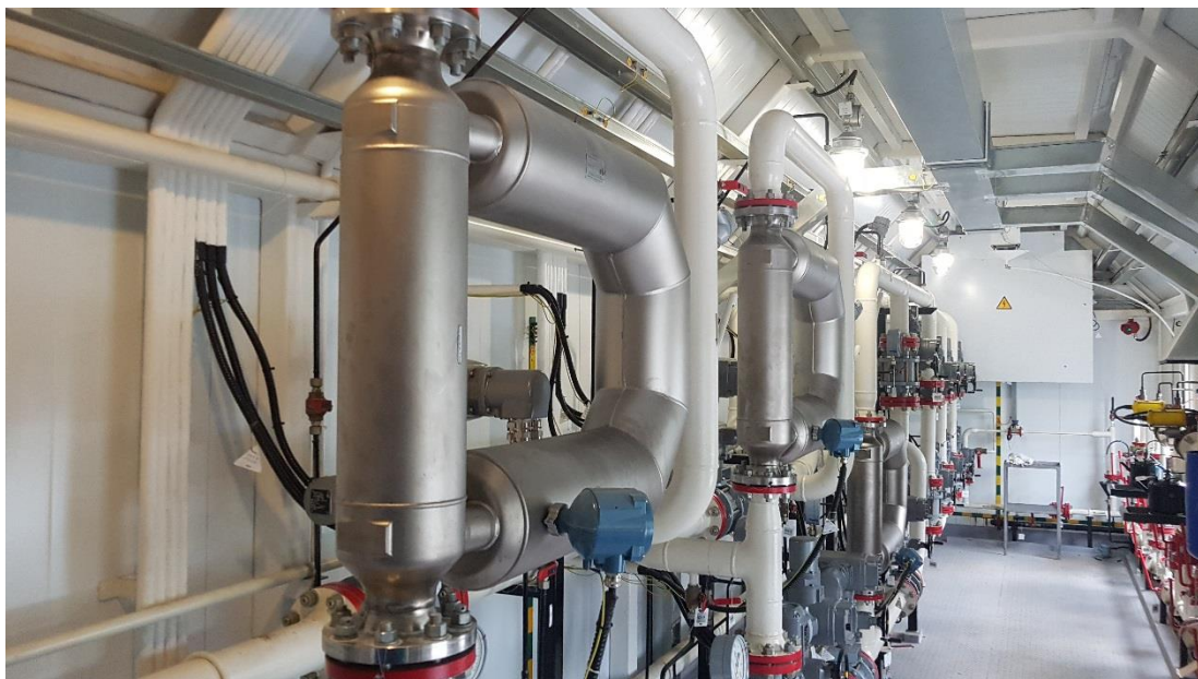
Рисунок 1 – Общий вид СИКН
