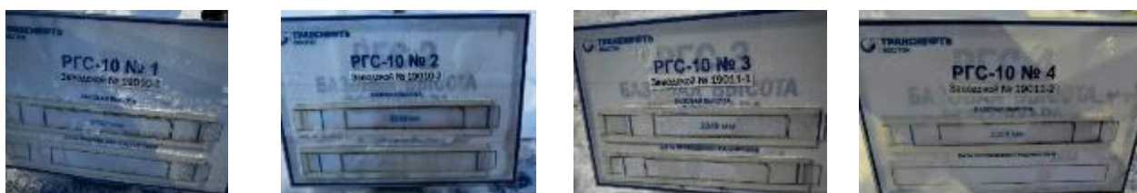
Рисунок 3 – Места нанесения заводских номеров резервуаров
