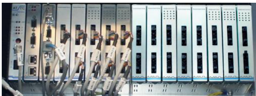
Рисунок 2 – Общий вид контроллеров с блоком расширения
