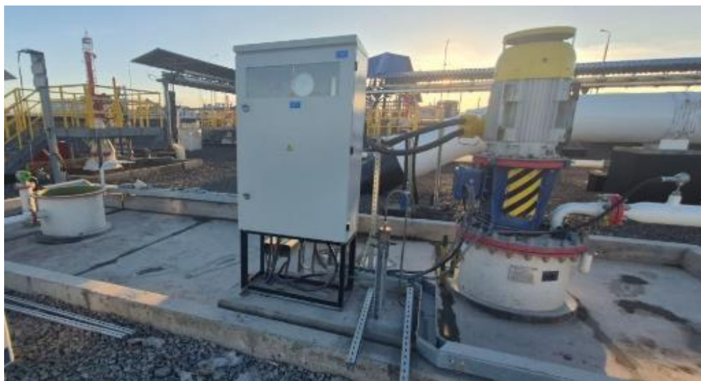
Рисунок 3 – Общий вид резервуара с измерительными люками и горловинами
