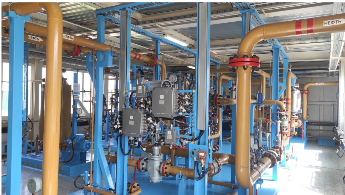
Рисунок 2 – Общий вид СИКН
