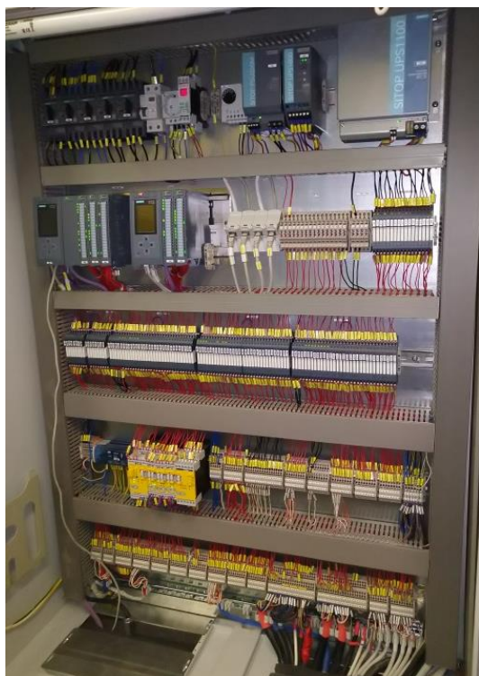
Рисунок 2 – Общий вид шкафа контроллера
