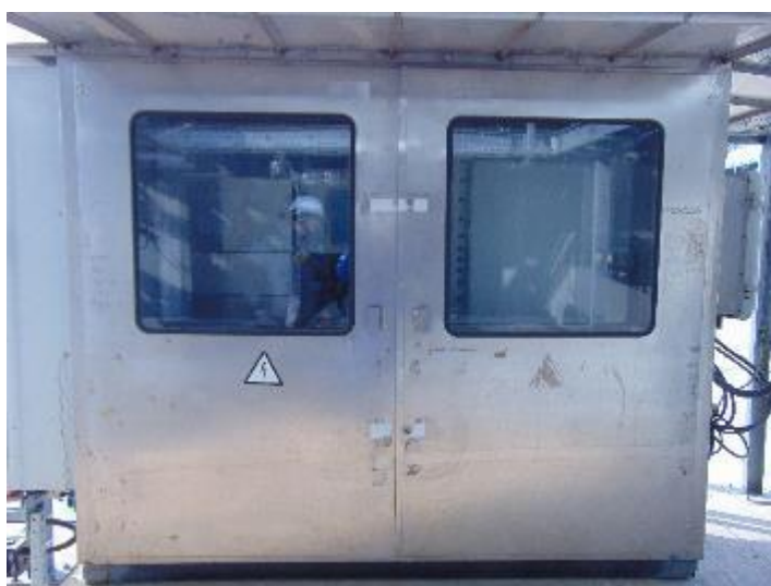
Рисунок 2 – Общий вид защитного шкафа DB1
