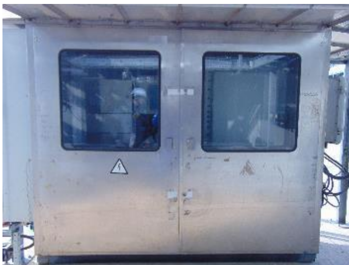
Рисунок 2 – Общий вид защитного шкафа DB1
