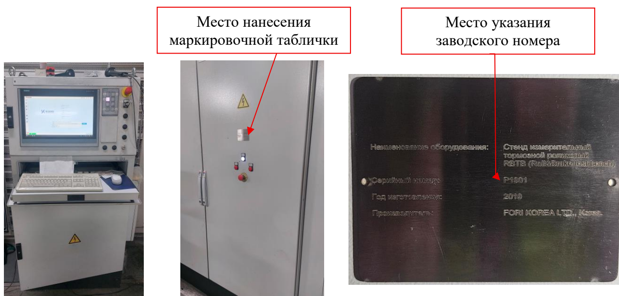
Рисунок 3 – Общий вид приборной стойки с пультом управления и компьютером
