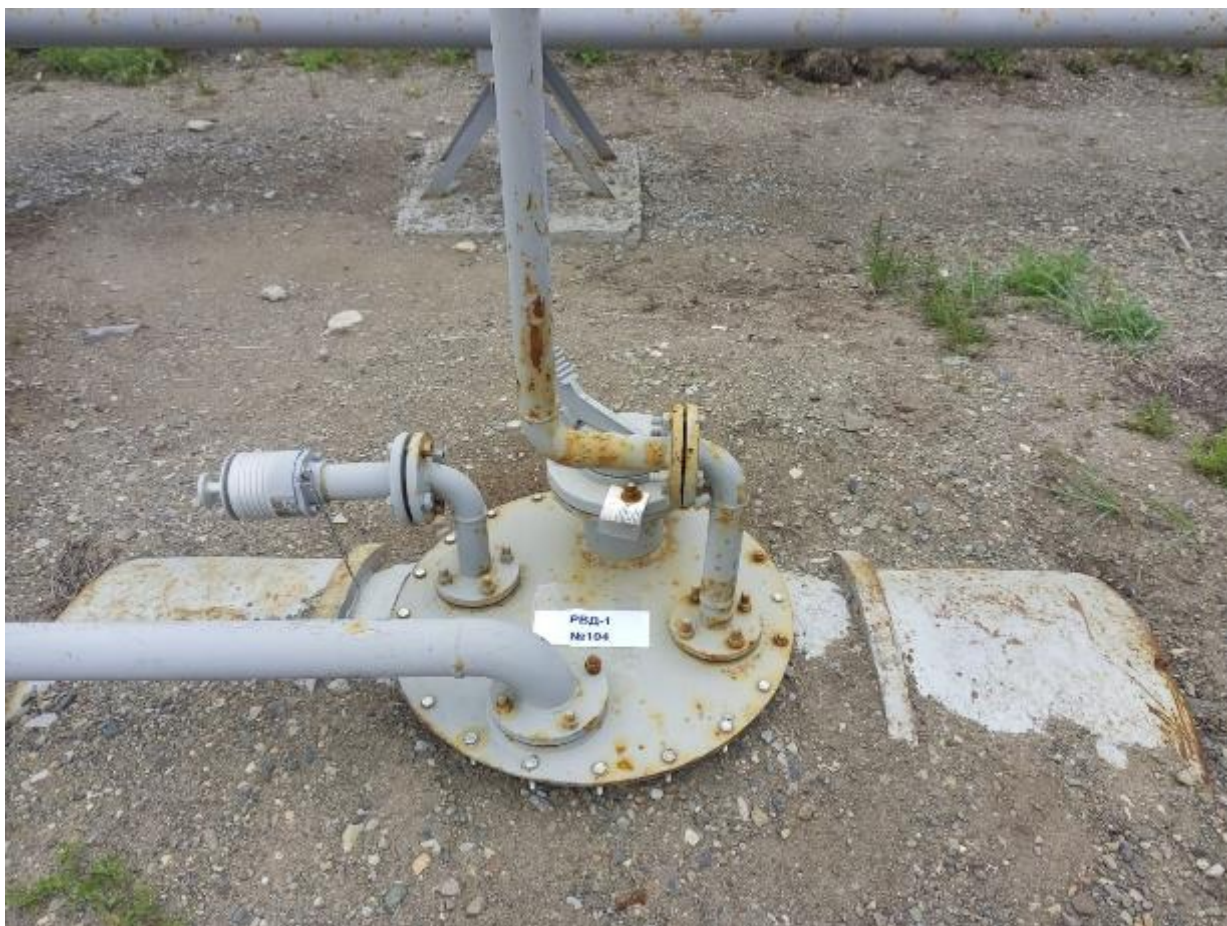
Рисунок 2 – Горловина резервуара РВД-1 зав.№ 104
