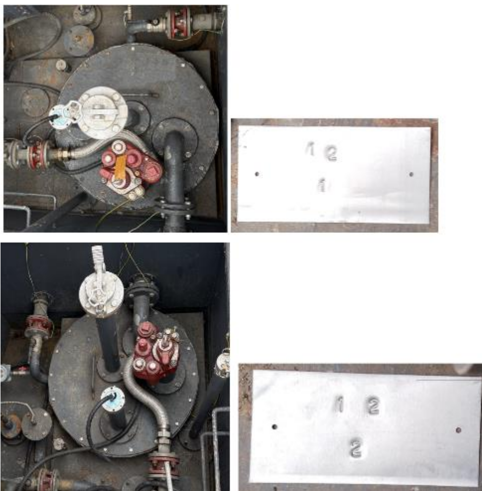
Рисунок 4 – Маркировочные таблички и горловины резервуара РГС-50 (25+25) зав.№ 12
