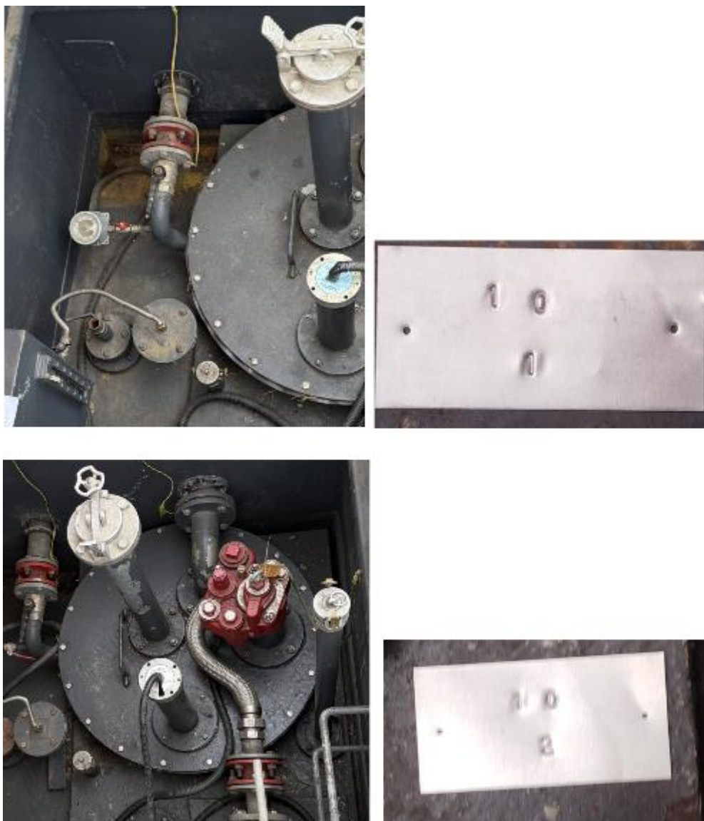
Рисунок 3 – Маркировочные таблички и горловины резервуара РГС-50 (25+25) зав.№ 10
