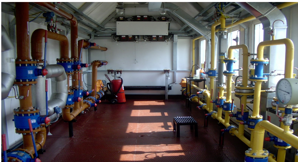
Рисунок 2 – Общий вид СИКН
