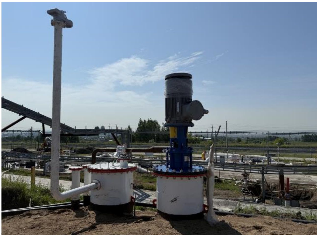
Рисунок 3 – Горловины и измерительный люк резервуара ЕП-12,5-2000-1500-А-С-У1 зав.№ 390
