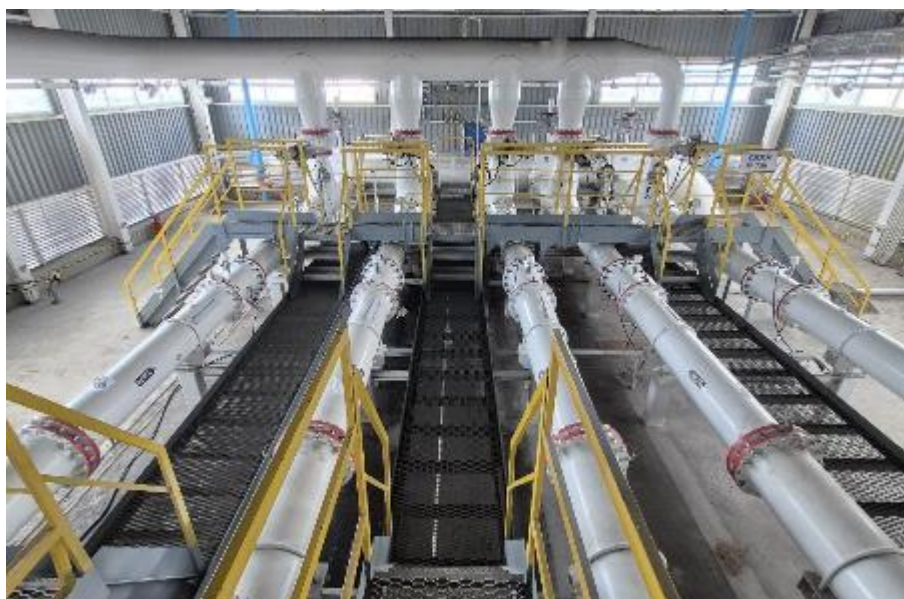
Рисунок 1 – Общий вид СИКН
