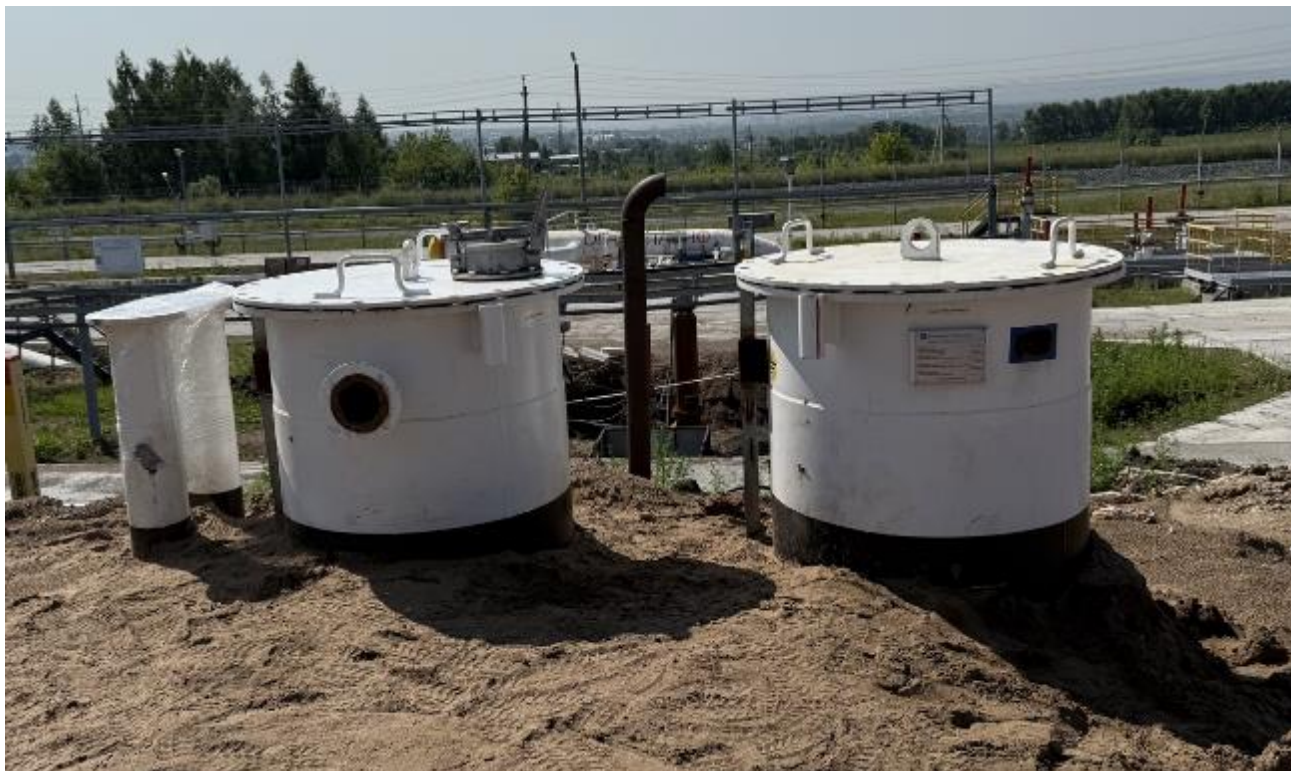
Рисунок 3 – Горловины и измерительный люк резервуара ЕП-12,5-2000-1500-А-С0-ХЛ1 зав.№ 330
