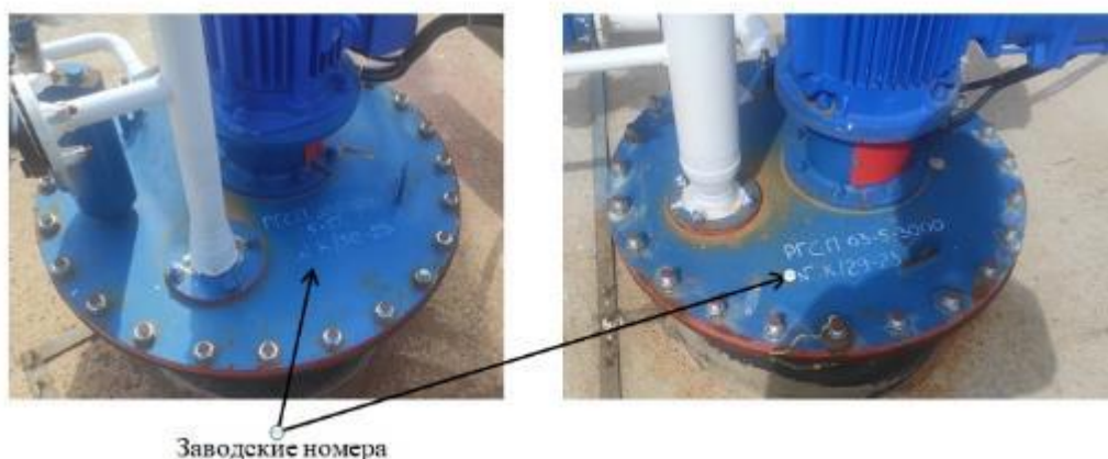
Рисунок 4 – Внешний вид эксплуатационных горловин резервуаров с указанием мест нанесения заводских номеров
