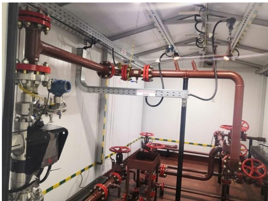
Рисунок 2 – Установка измерительная «Мера-МР». Общий вид. Блок технологический
