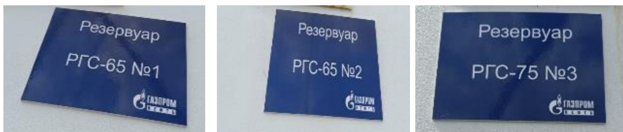
Рисунок 2. Таблички с заводскими номерами резервуаров РГС-65 и РГС-75
