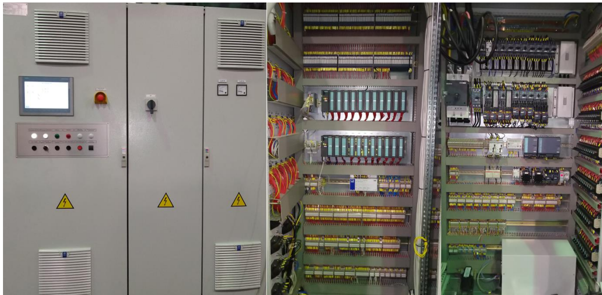
Рисунок 1 – Общий вид щита управления РО55 (ЩУ2)
