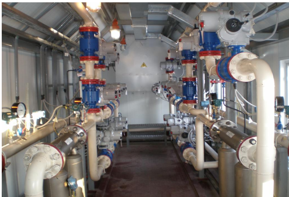
Рисунок 3 – Общий вид СИКН
