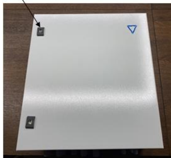
б) шкаф управления
