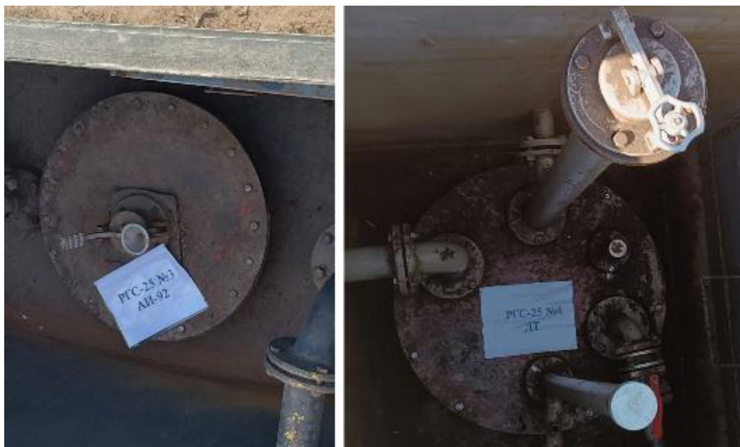
Рисунок 4 – Горловины резервуаров РГС-25 зав.№№ 3, 4
