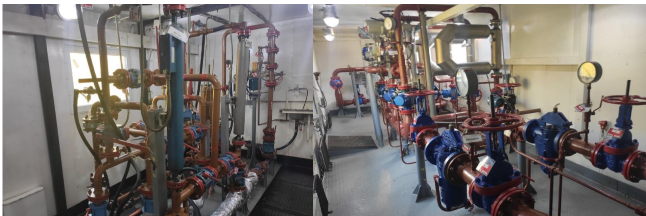
Рисунок 2 – Общий вид СИКН
