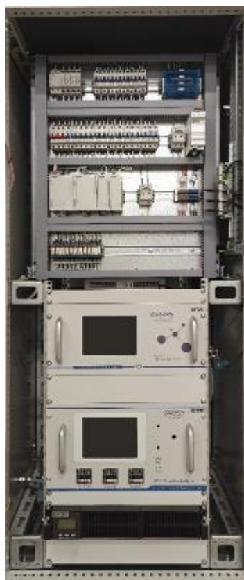
Рисунок 3 – Общий вид внутренней части шкафа с газоаналитическим оборудованием
