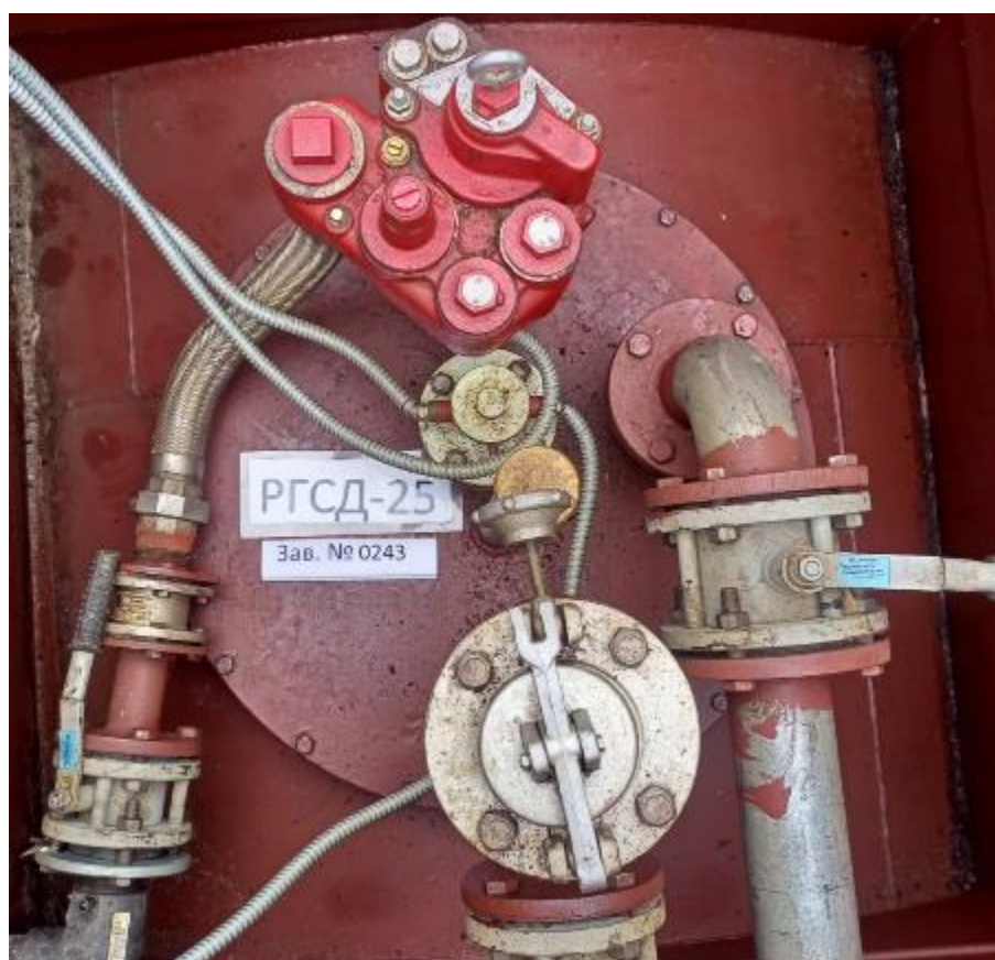
Рисунок 8 – Горловина и измерительный люк резервуара РГСД-25 зав.№ 0243
