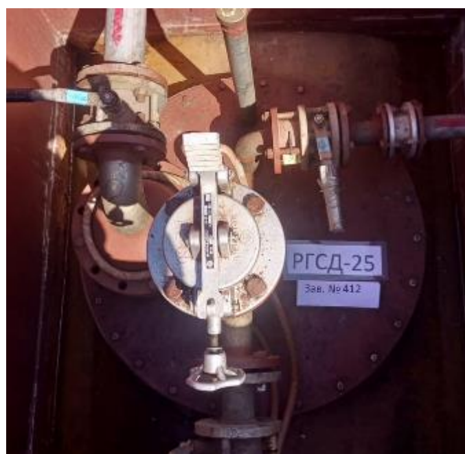
Рисунок 3 – Горловина и измерительный люк резервуара РГСД-25 зав.№ 412
