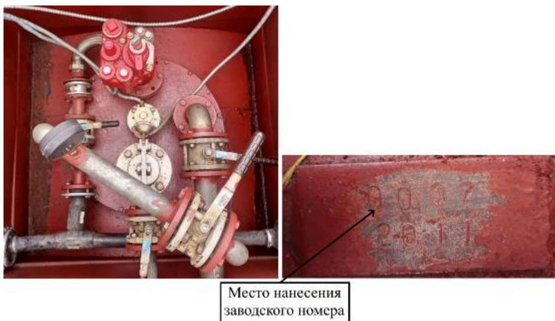
Рисунок 5 – Горловина и измерительный люк резервуара РГСД-25 зав.№ 0007
