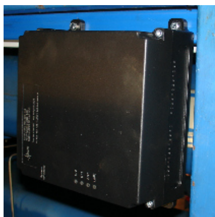
Рисунок 9 – МПС-140/48 на месте установки. Вид внешний
