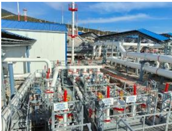
Рисунок 1 – Общий вид СИКН
