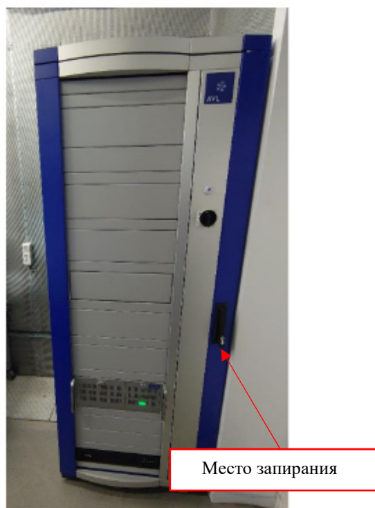
Рисунок 1 – Шкаф системы управления PUMA
