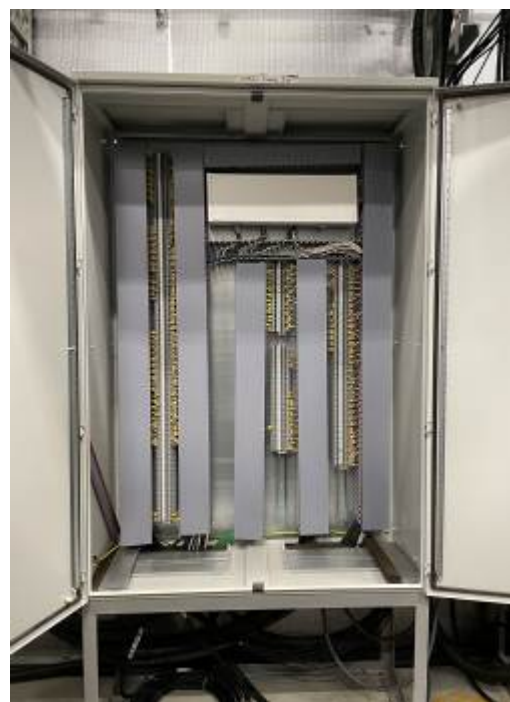
Рисунок 5 – Общий вид шкафов кроссового оборудования ШКО1, ШКО3, ШКО4
