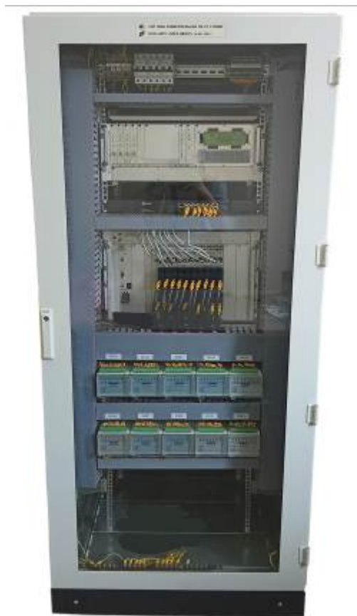
Рисунок 2 – Шкаф измерительного оборудования ШИО
