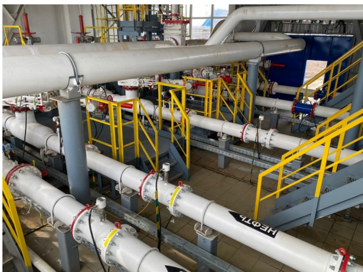
Рисунок 1 – Общий вид СИКН
