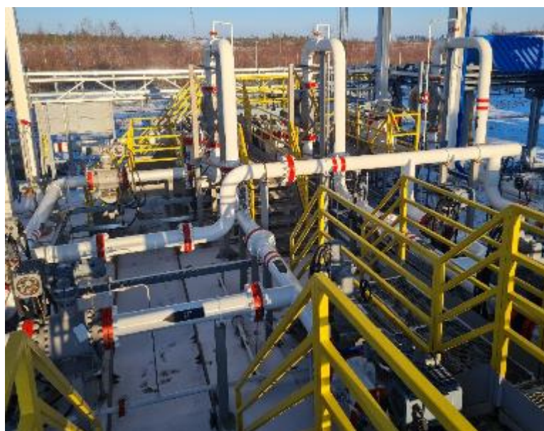
Рисунок 1 – Общий вид СИКН
