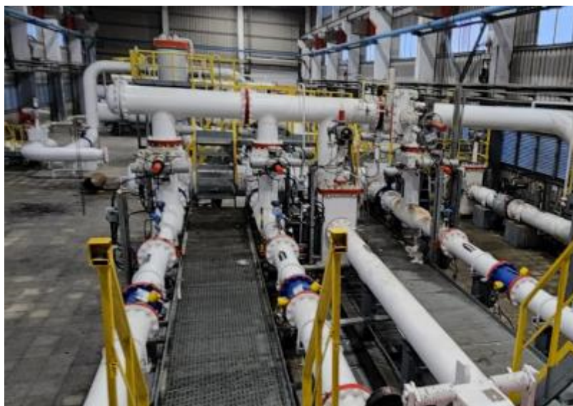
Рисунок 1 – Общий вид СИКН
