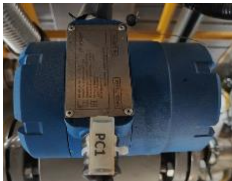
Рисунок 15 – Счётчик ультразвуковой объёмного расхода ВЗЛЕТ УРСВ-744 в месте установки
