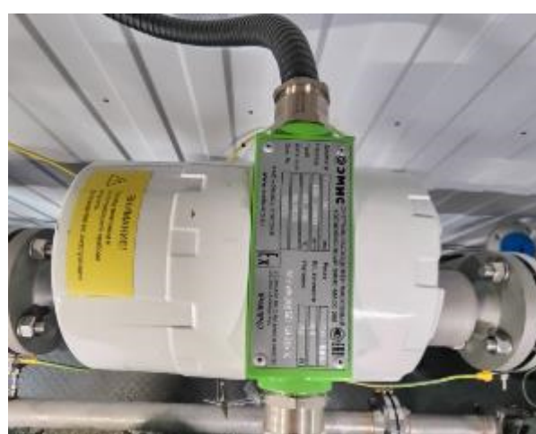
Рисунок 14 – Счётчик-расходомер массовый ЭМИС-МАСС-260 в месте установки
