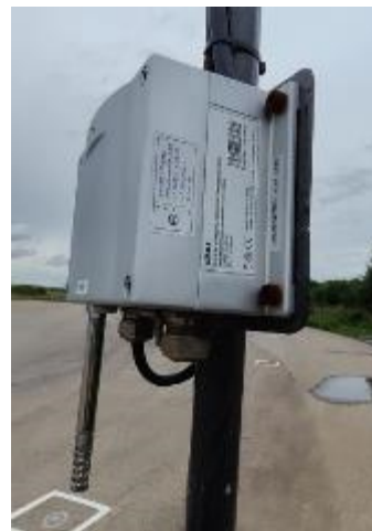
Рисунок 16 – Преобразователь измерительный атмосферного давления, относительной влажности и температуры воздуха Vaisala RTU300 в месте установки
