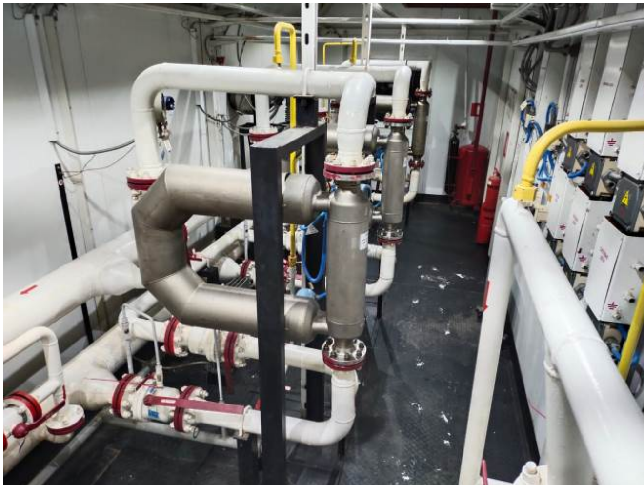
Рисунок 1 – Общий вид блока измерительных линий СИКНС
