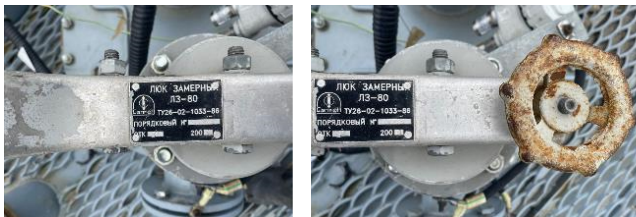
Рисунок 3 – Замерные люки резервуаров РГС-20
