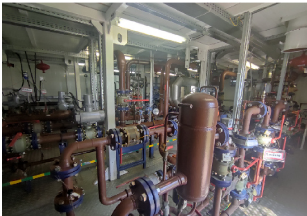
Рисунок 2 – Общий вид СИКН
